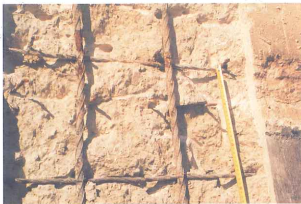
Figura 10.- Cata para comprobar el estado de la armadura.
