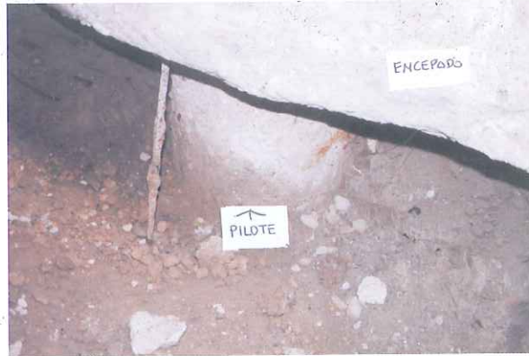
Figura 3.- Cata realizada en el terreno, junto al encepado, para la comprobación de uno de los pilotes de hormigón.
