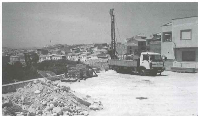
Vista general del equipo de sondeos durante la realización de los trabajos de perforación en el solar objeto de estudio.
