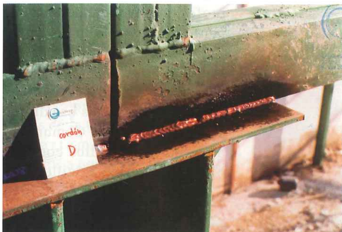
Detalle de la aplicación de Líquidos Penetrantes, donde se observa discontinuidad del cordón y defectos en el inicio y final de su recorrido.
