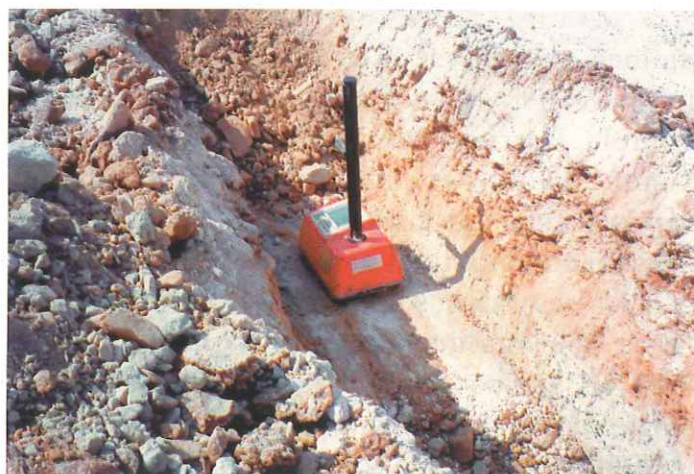
Detalle del equipo de Isótopos Radioactivos (Método Nuclear) para la comprobación de los niveles de calidad de la compactación de la solera de la obra.
