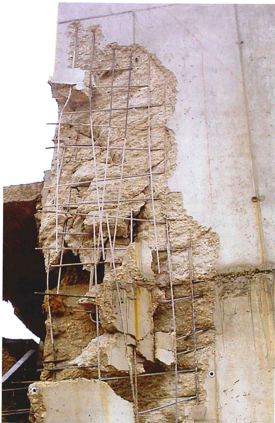
Detalle de la influencia por la rotura del muro, en una junta de hormigonado. Véase el estado en que quedó la armadura y el hormigón de su recubrimiento
