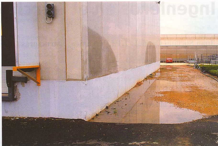
Aspecto general de una nave industrial con importantes afecciones por presencia de agua en su entorno, que puede conllevar, con el paso del tiempo, la aparición de lesiones por asientos diferenciales en su cimentación
