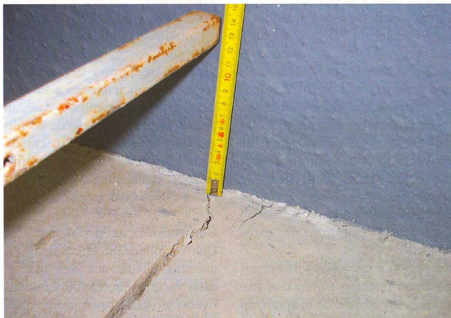
Detalle de una comprobación del asiento de cimentación en una nave industrial, mediante el seguimiento de los desniveles aparecidos en la solera de hormigón, respecto a la placa de cerramiento
