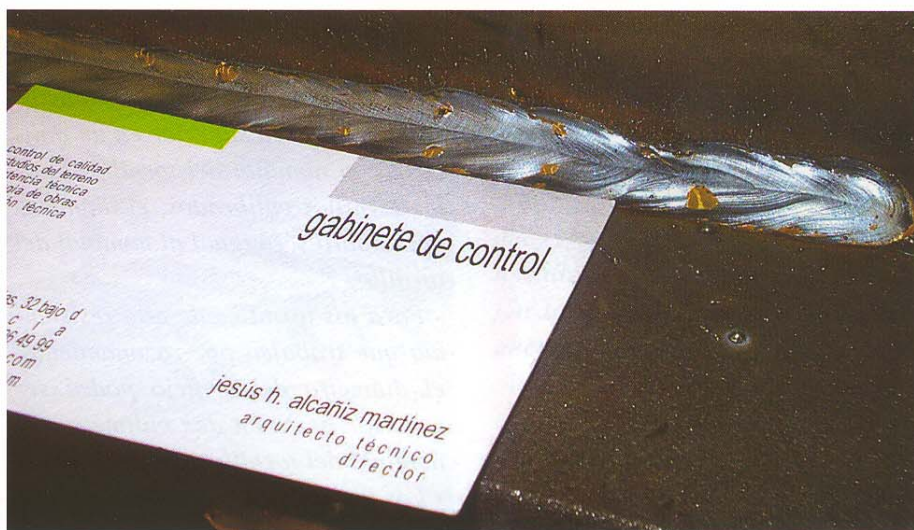
Detalle de un cordón de soldadura, mediante hilo, continua, en taller. Véase la calidad de su ejecución y la uniformidad de su trazado
