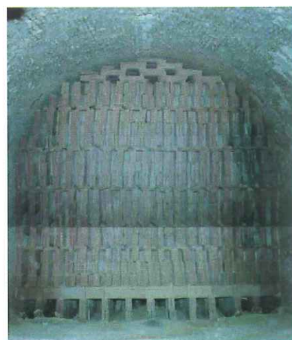
Aspecto general del interior de un horno
