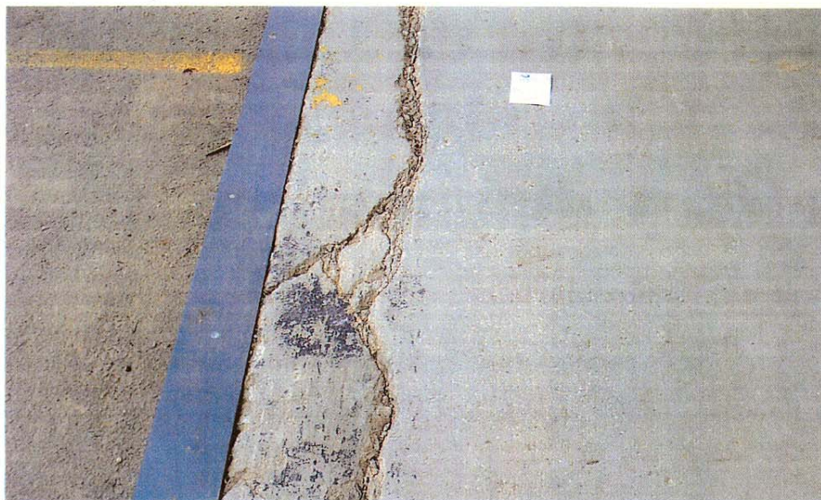
Detalle de una importante grieta y deterioro existente junto a zona de muelle de descarga, junto al elemento metálico de protección, debido a los golpes de los vehículos, en la maniobra de descarga
