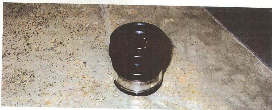
Detalle del proceso de medición de grietas y fisuras en una solera de hormigón, mediante lupa de gran aumento con micrómetro incorporado
