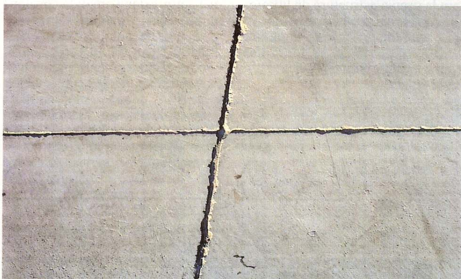
Dos aspectos de las juntas en solera donde se aprecia el deterioro superficial de los labios de la junta (por falta de sellado) y un importante deterioro de la junta por una inadecuada solución en su trazado
